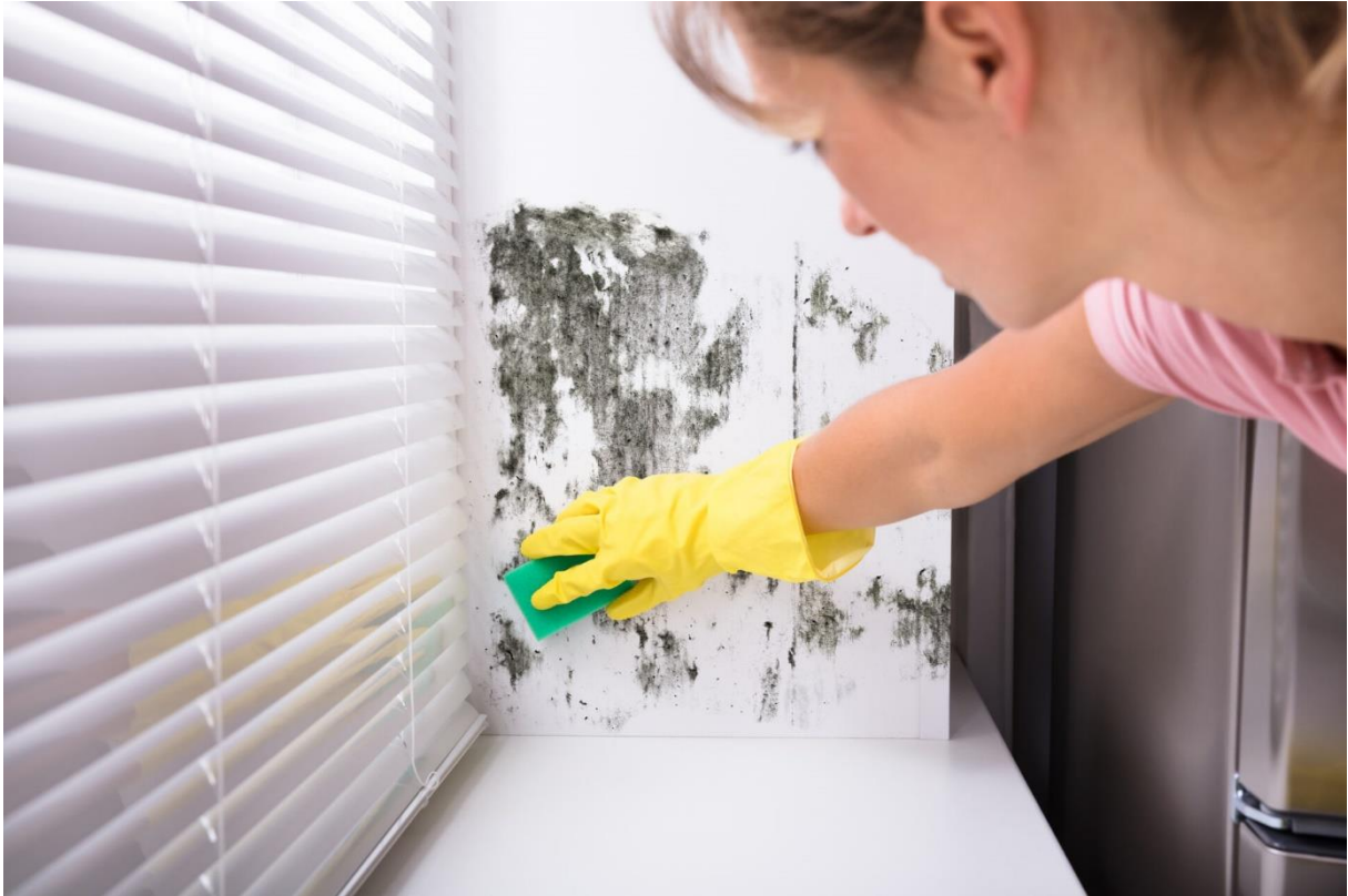
Meer schimmel in huurwoningen door water in kruipruimte of kelder
